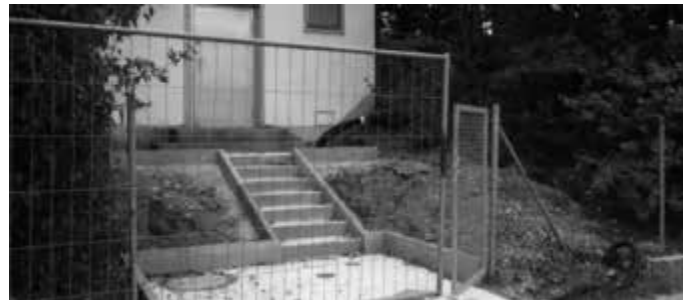
Außenanlage Hochbehälter Saulach
