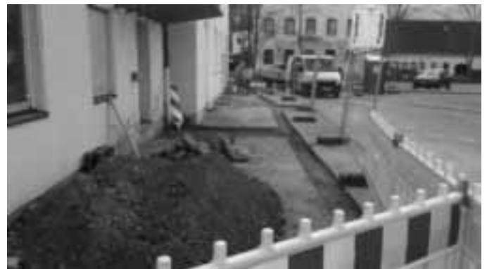
Bahnhofsgebäude - Wasser, Kanal, Strom, Gas, Daten
