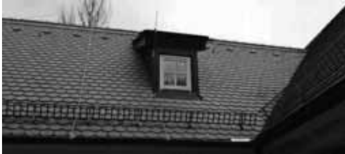
Blitzschutz auf dem Dach des Kindergarten St. Sempert
